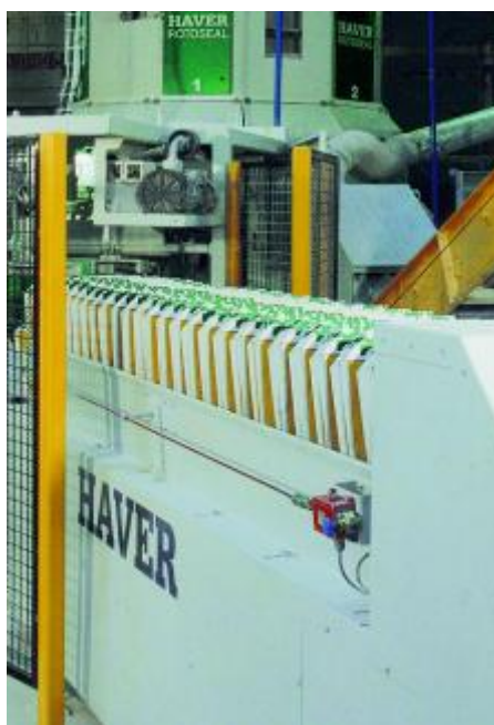
Общий вид установки
